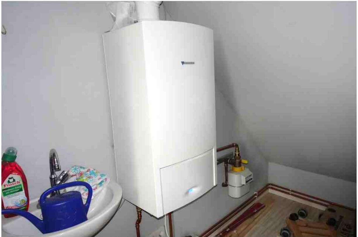
KIRCHSTRASSE 2, WERDER (HAVEL) Gas-Brennwerttherme im DG
